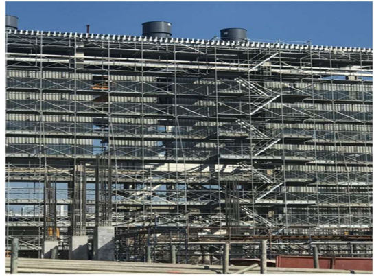
โครงการก่อสร้างงานระบบประกอบอาคาร TUM 3.2
